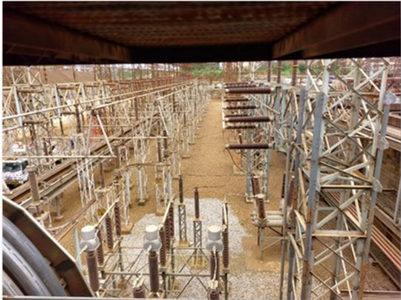
Gambar 37. Kondisi Lapangan Jalur Alternatif Auxiliary Grid
